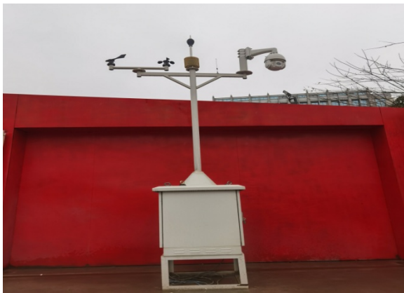
图 16 扬尘监控设备
