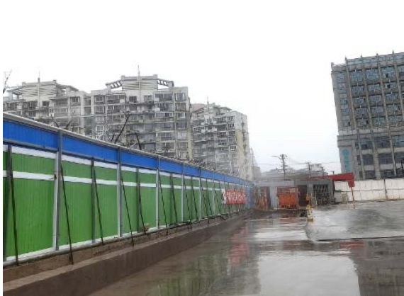
图 18 围墙喷雾降尘装置
