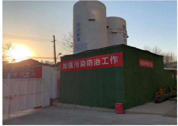
图 21 散装水泥筒仓全封闭
