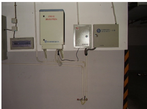
图5.6 室内覆盖设备图
