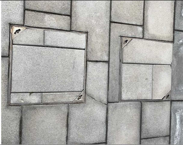
DW001 生活污水排口
